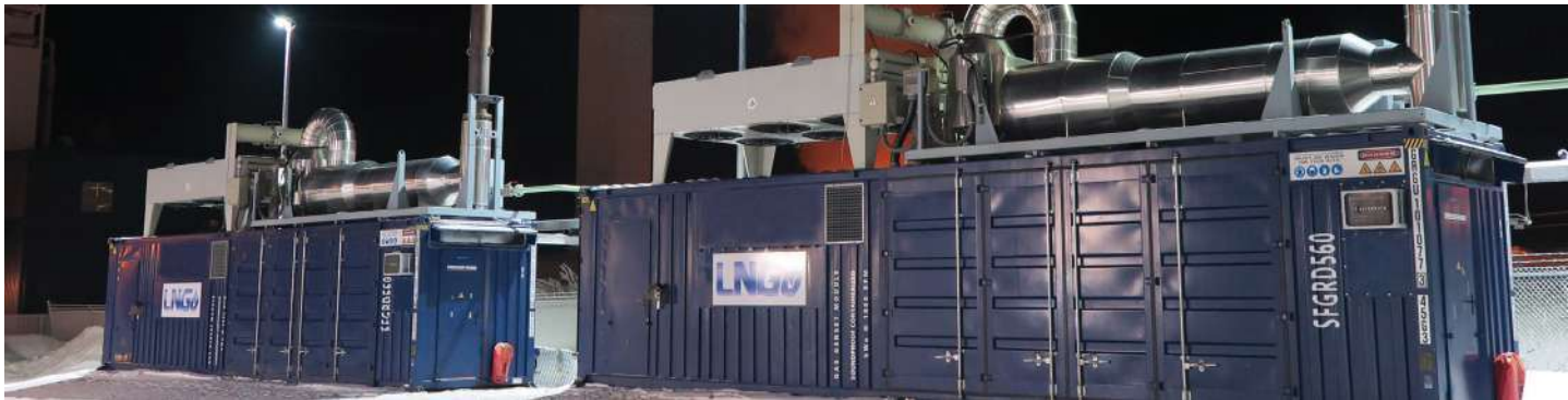
LNGo Power modules (SL), Altagas Ltd. British Columbia, Canada.
